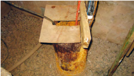
Mangelhafte Abdeckung Brunnenrohr
