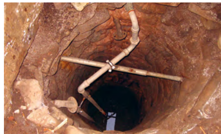
Korrodierte Rohre, starke Eisenoxidausfällungen
