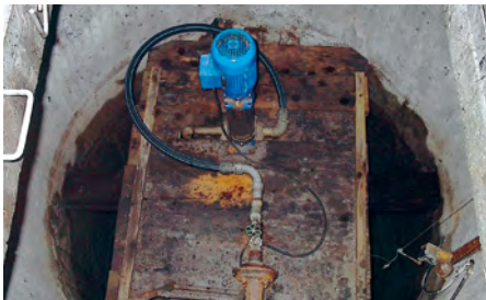
Stark verschmutzte, offene Holzabdeckung
