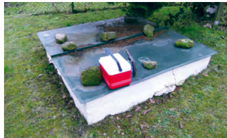
Undichte, mangelhafte Abdeckung
