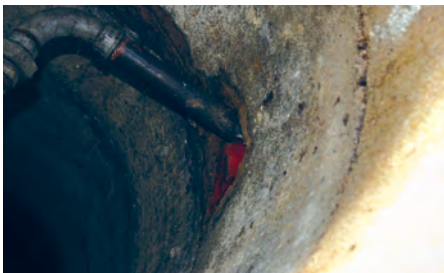
Nicht ausreichend abgedichtete Rohrdurchführung
