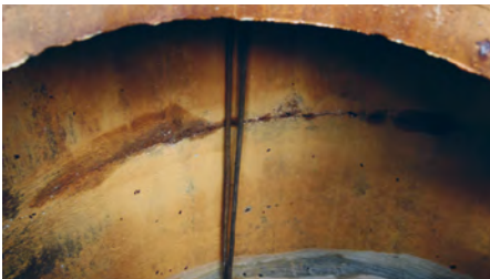
Feuchtigkeitseintritt zwischen Schachtringen
