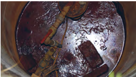
Verschlammter Vorschacht und verrosteter Brunnenkopf
