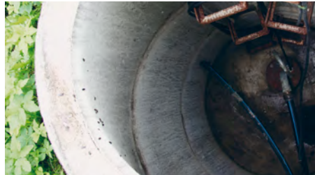
Schädlinge im Schacht durch nicht dicht aufliegenden Deckel
