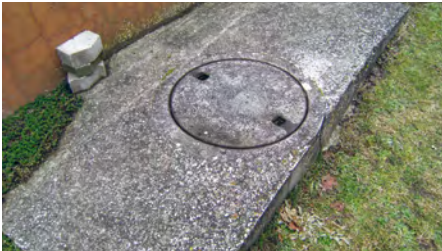
Risse in der Betoneinfassung führen zu Undichtigkeiten
