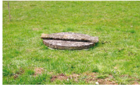
Betondeckel nicht tagwasserdicht
