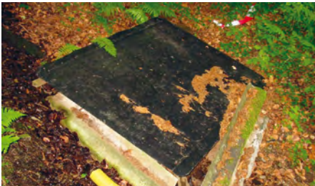
Unzureichende Abdeckung und provisorische bauliche Gestaltung einer Quellfassung
