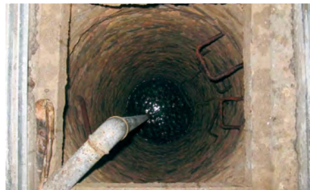
Eisenteile in Schachtbrunnen
