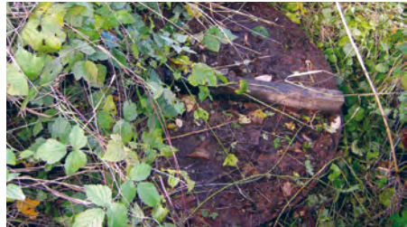
Korrodierte, nicht tagwasserdichte Abdeckung
